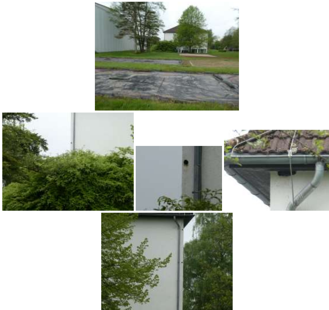
Abbildung 6: Mehrere Fotos der Ostfassade des Schulgebäudes, daran nisten an mehreren Stellen in Hohlräumen der Fassadenisolation Stare und Haussperlinge.
